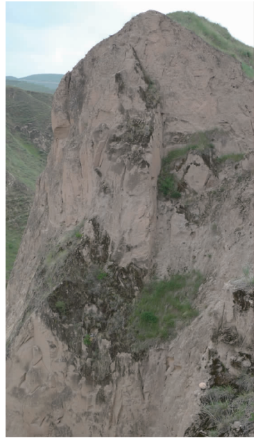
图5 南边城墙垮塌的断面
