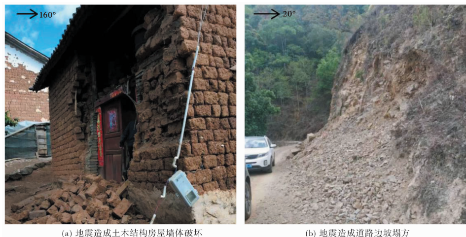
注：图片源自云南隆阳 5.2 级地震现场调查工作组。
